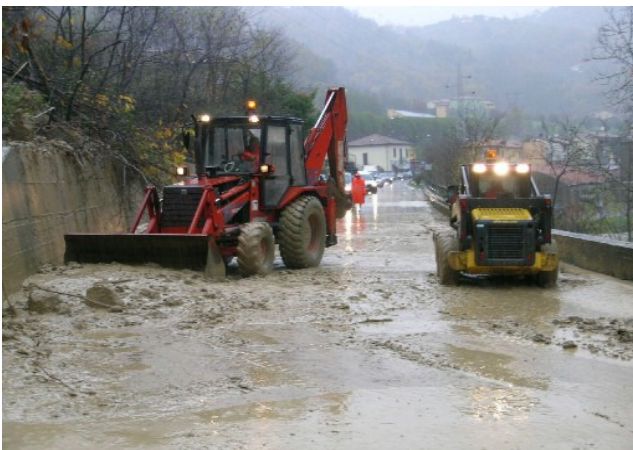
Grosso smottamento sulla statale 325 nel Pratese (foto Batavia, Il Tirreno)
